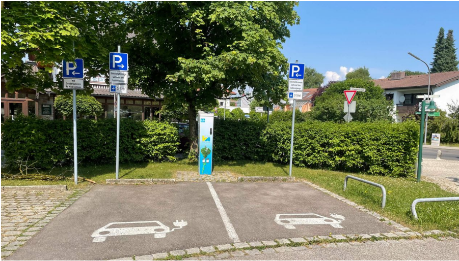
E-Ladestation-Krankenhaus-Bad-Aibling - © AIB-KUR GmbH & Co. KG
