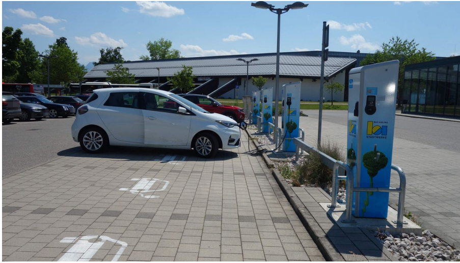
E-Ladestation-Parkplatz-Therme-Bad-Aibling - © AIB-KUR GmbH & Co. KG
