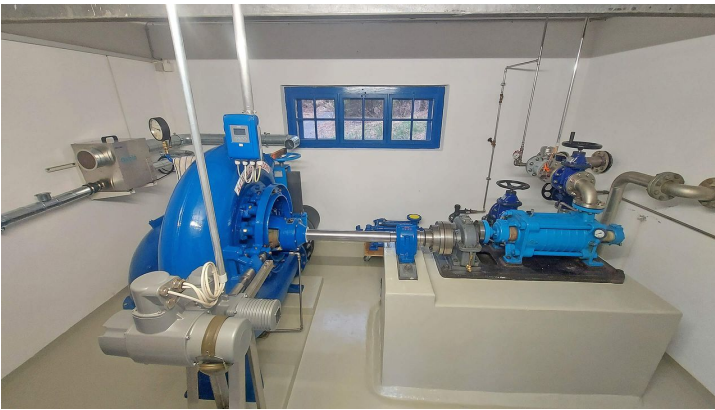
Das Maschinenhaus der Trinkwasserversorgung - © Thomas Gartwyl
